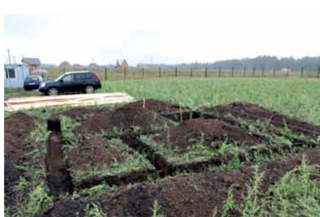
Торфяник. Здесь логично заливать плитный фундамент, но никак не ленточный!
